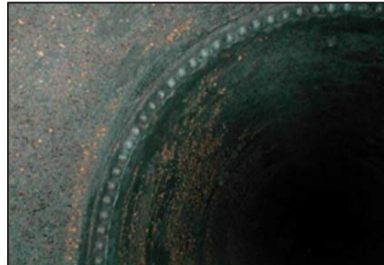
Corrosión por picadura sobre paredes con ARC 858 y ARC 855 pasados 14 años.
